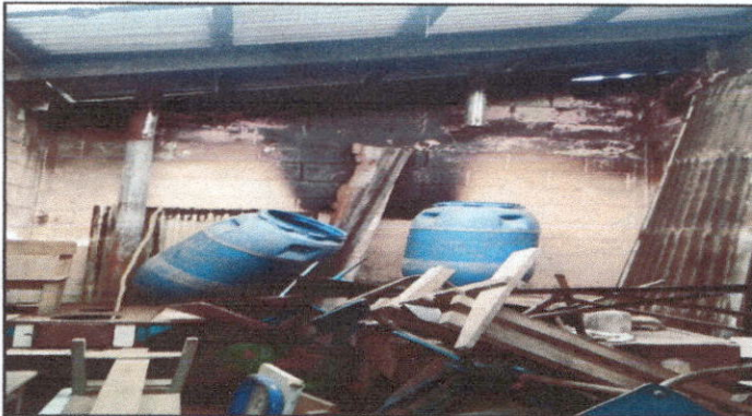
Foto 3: Falta de pintura, chimenea y estufa en mal estado
