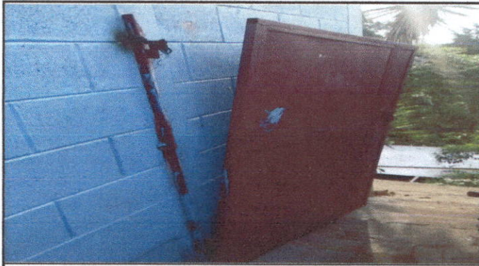
Foto 1: Cambio de puerta por deterioro en mal estado
