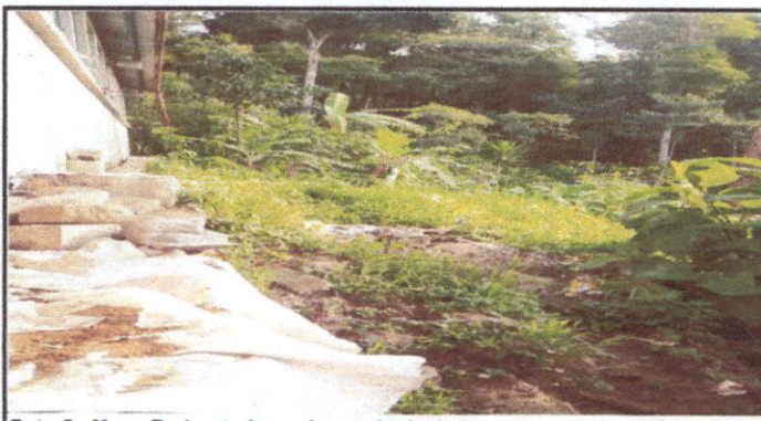
Foto 5: Muro Perimetral por riesgo de deslave
